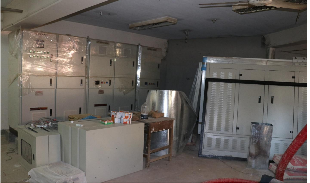
নবনির্মিত ৮০০কেভিএ সাবস্টেশন এবং ৩০০ কেভিএ জেনারেটর
