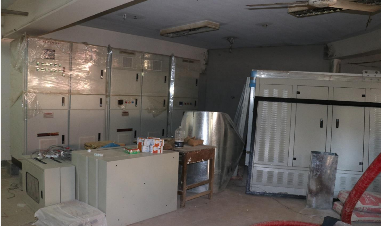
নবনির্মিত ৮০০কেভিএ সাবস্টেশন এবং ৩০০ কেভিএ জেনারেটর
